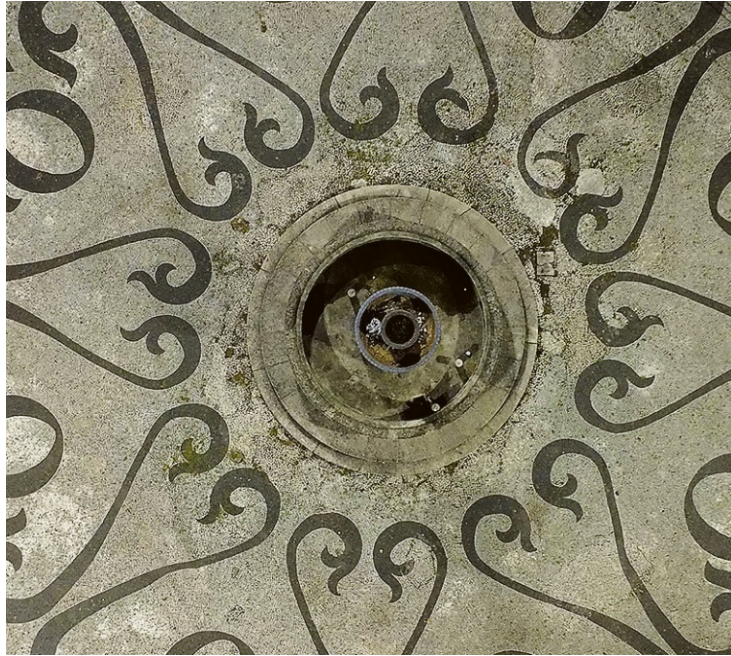
Obra francesa. Em ferro fundido, fonte da Praça Nicarágua está desligada
