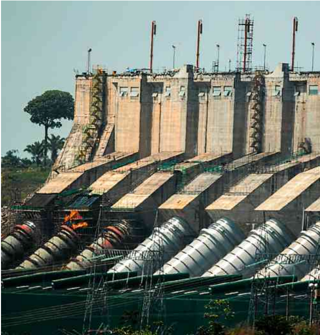
Turbinas na hidrelétrica de Belo Monte (Pará), na qual a Neoenergia tem participação
