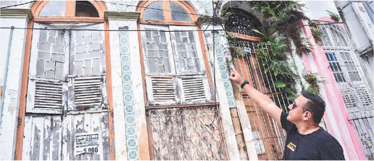
Francisco Júnior detalha a dimensão do problema na Campina: “Essas residências estão em um estado crítico, sem manutenção há anos”
