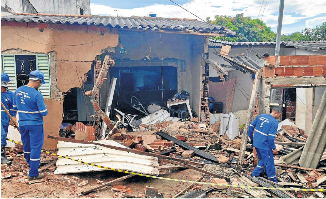
Duas casas no Condomínio Mirante da Serra Villa Rabelo, em Sobradinho II, foram interditadas
