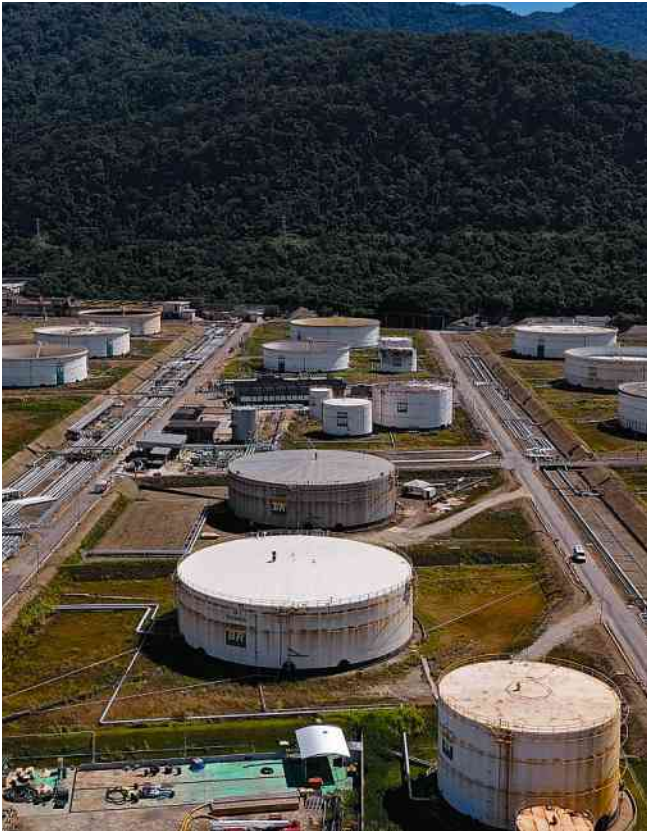
Tanques e dutos em terminal da Petrobras no porto de São Sebastião, em SP
