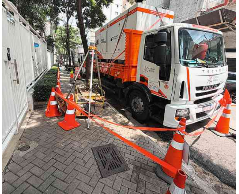
Caminhão da Enel com gerador em rua que ficou dias sem energia devido ao apagão na capital paulista Clauber Larre - 6.fev.26/Folhapress
