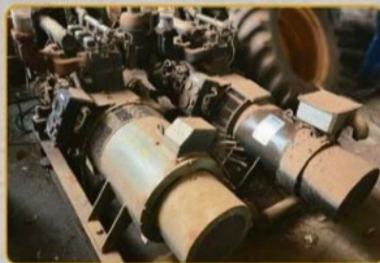
2 GRUPOS GERADORES C/ MOTORES MWM
