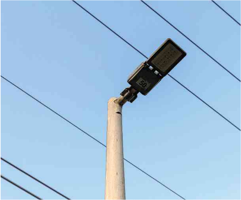
Poste de luz apagado próximo à ponte Cidade Universitária, na zona oeste de São Paulo Eduardo Knapp - 7.ago.25/Folhapress
